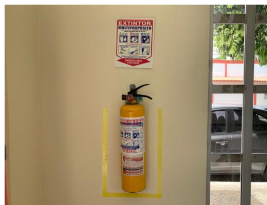
Extintor contra incendios
