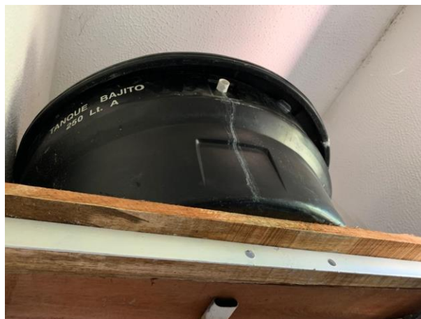
Tanque de almacenamiento de agua potable
